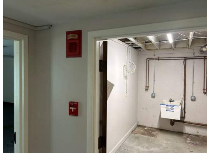
Fire Alarm Annunciator
